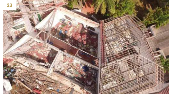
Figura 23. Facultad de Bellas Artes, Universidad del Atlántico. Desplome del techo de dos salones de música. 18 de junio de 2017. Vista aérea. Fotografía: Roberto Camargo.
